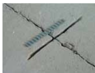
Lărgirea fisurilor Crestarea transversală
