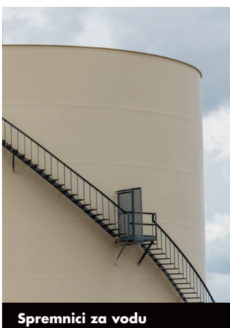
Spremnici za vodu
