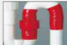
色による配管識別
