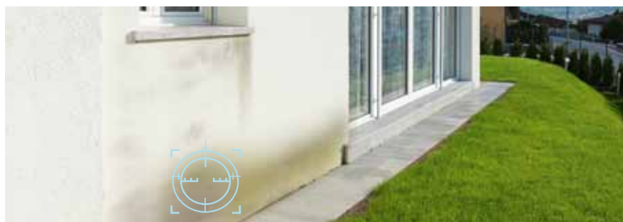
Tencuială neprotejată, contaminată biologic. Fațadă murdară și inestetică.
