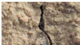
Apare prima fisură
