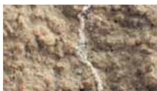
După 54 zile, fisura este complet acoperită
