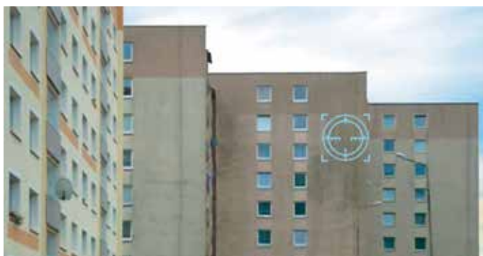
Textura sin garantía con contaminación biológica. Fachada sucia y antiestética.
