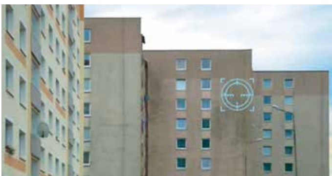
Estuco sin garantía con contaminación biológica. Fachada sucia y antiestética.
