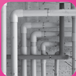
Lignes d'alimentation en produits chimiques ou en eau chaude, comme dans les usines de traitement des eaux usées.
