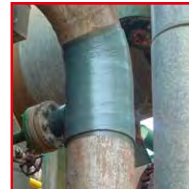
Instalacje rurowe i armatura
