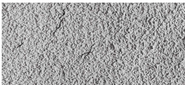
Inne tynki po latach eksploatacji
