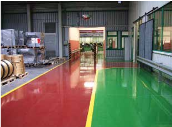
Ipari csarnok padlóbevonata Száras technológiájú helységek
