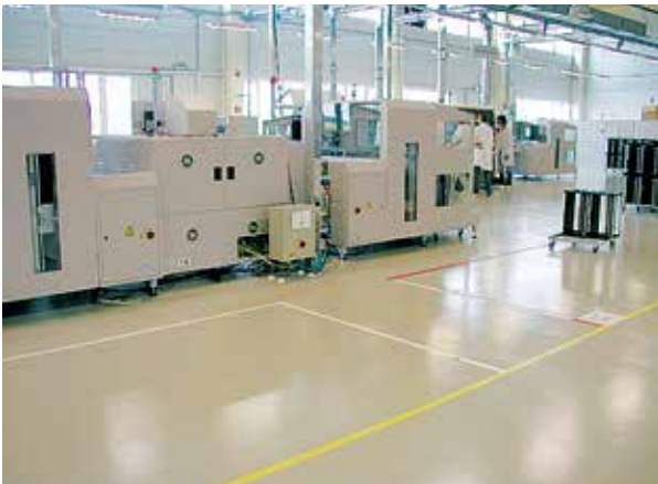
Ipari csarnok padlóbevonata Száras technológiájú helység, elektrosztatikus vezetőképességi igény
