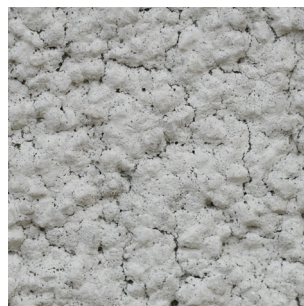
Malter sa mikropukotinama
