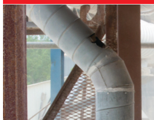
Tuyaux et conduits
