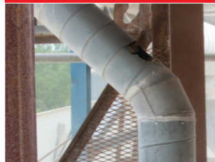
Tuyaux et conduites
