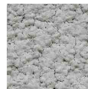
Tynk z mikropęknięciami
