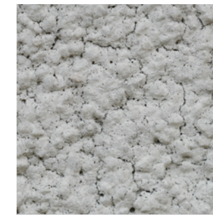
Žbuka s mikro pukotinama
