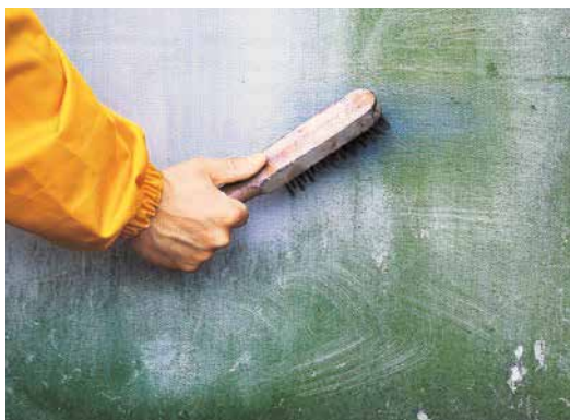
Pirms gruntēšanas pamatni attīra no vajējiem putekļiem
