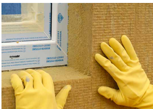
Logu un durvju stūros izmanto L formā grieztas plāksnes
