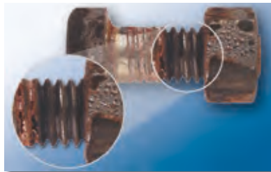
ロックタイトねじゆるみ止め接着剤が塗布されていない錆びたボルトの締結部分
