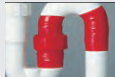
色による配管識別
